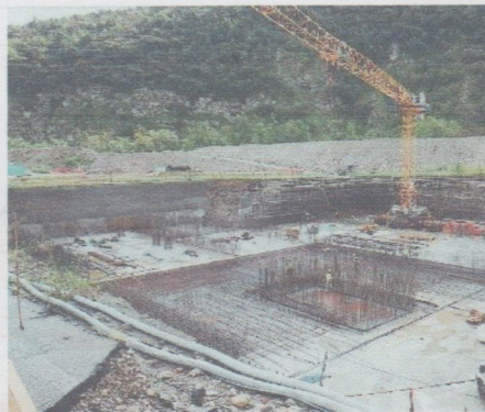
Concesso. Il cantiere Asvt per il depuratore della Valtrompia, pronto a fine anno
