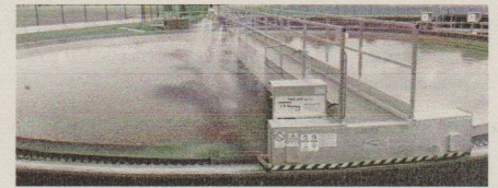
Uno degli impianti gestiti da Acque Bresciane: la società con sede legale in città gestisce attualmente il servizio idrico integrato in 94 comuni. Nel 2032 l'obiettivo è coprire tutta la provincia
