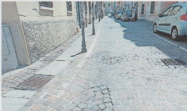
In pieno centro. La strada in alcuni punti è dissestata: gli avvallamenti verranno eliminati in estate
