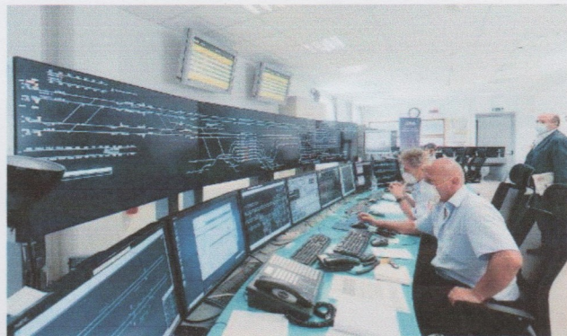
Sala operativa. La stazione vanta un nuovo apparato centrale computerizzato (Acc) // FOTO ORTOGNI/NEG
